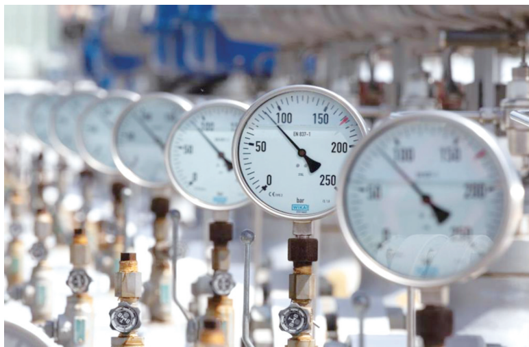
这是2022年5月20日在匈牙利饶瑙拍摄的匈牙利最大天然气存储设施。
