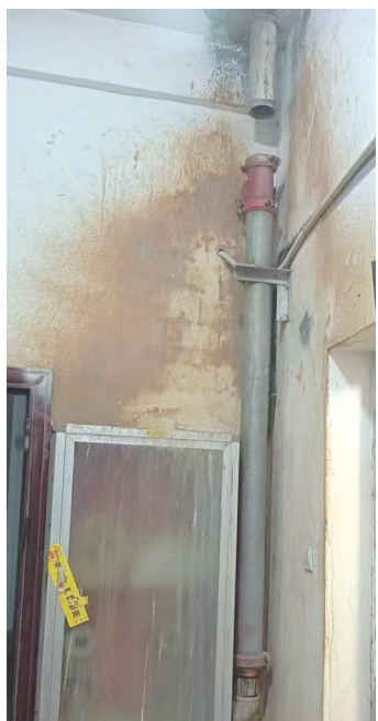
▲消防栓管道缺了一截 图片由梁女士提供
