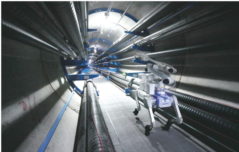
5月22日，智能巡检机器人在位于绍兴越城区的220千伏土井头电缆隧道进行无人化局部放电检测。 新华社发
