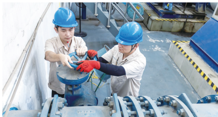
三水厂维修人员正在巡查供水设备。
