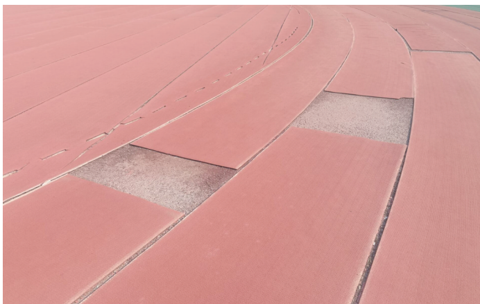
体育中心田径场内损坏的跑道。
